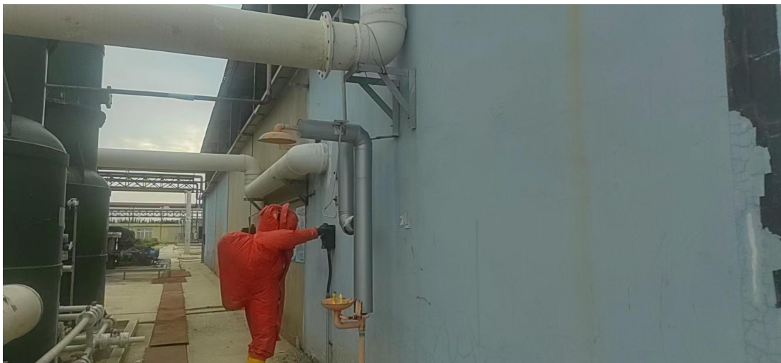
抢险救援人员现场启动事故风机
