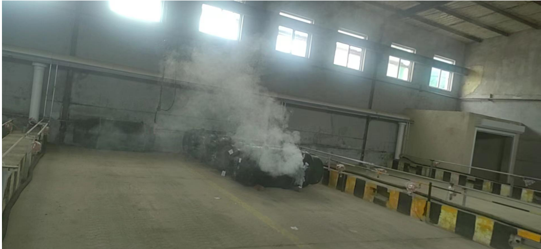
液氯发生泄漏
